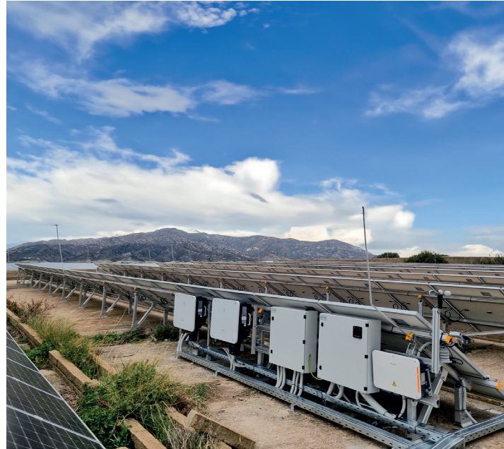
SG50CX-P2 με COM100E στο χώρο του έργου
